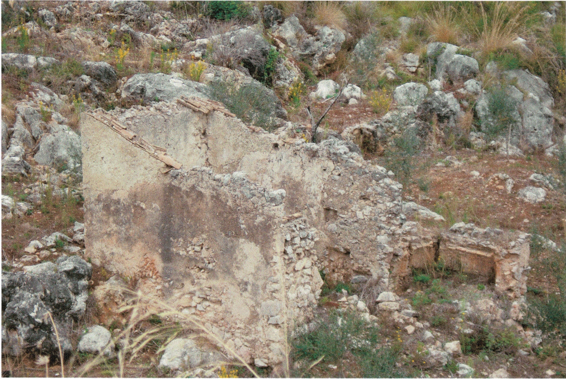
FABBRICATO DIRUTO (ZONA BASSA M. LAURO) P. 110 mq. 27
